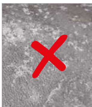
enostavna izvedba: Korozija
