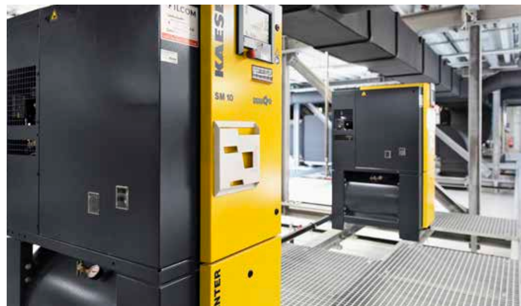
Za novi logistični center sta v uporabi dve napravi AIRCENTER.
